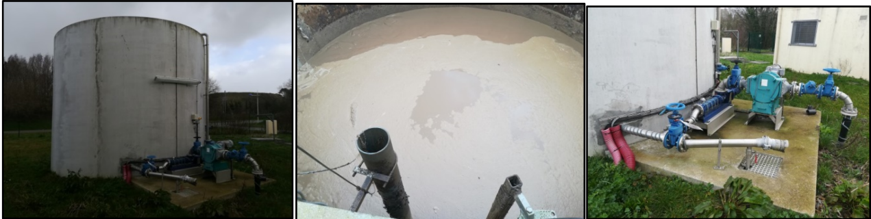
Figure 5 : Photos du silo de mélange des boues de la STEP du Porzo
